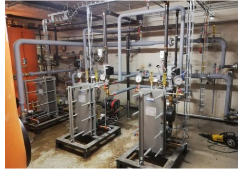
Figure 9 : Sous-station avec échangeurs
