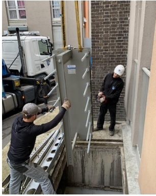
Figure 8 : Livraison échangeurs de sous-station
