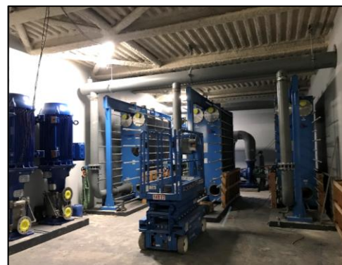
Figure 4: Echangeurs de chaleur géothermaux et pompes de réinjection
